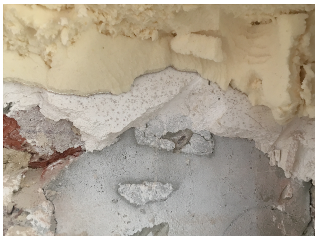
Développement de moisissures observé sur un plafonnage existant, derrière un panneau isolant de type « PUR
