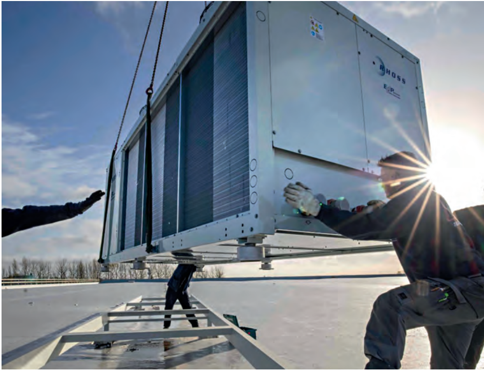
Au lieu d'opter pour un chauffage au gaz traditionnel et bon marché, Eutraco a investi dans des pompes à chaleur industrielles alimentées par des panneaux solaires.
