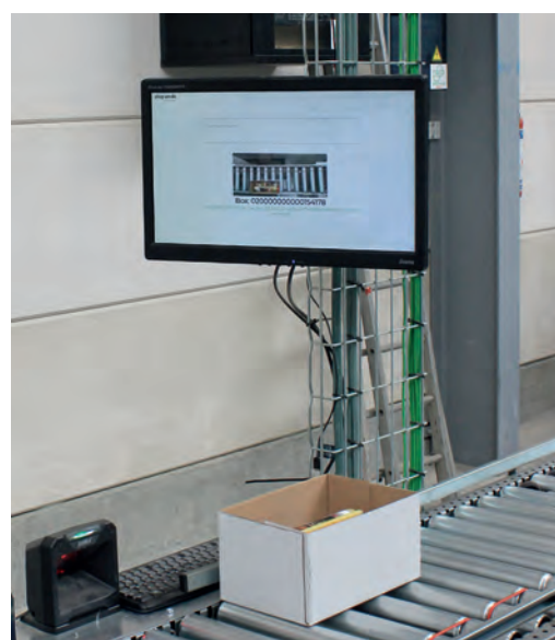
Juste avant le conditionnement, le BoxPick prend une photo de chaque commande qui est immédiatement disponible pour le client. Cela réduit, entre autres, le nombre de litiges de la part des clients finaux.
