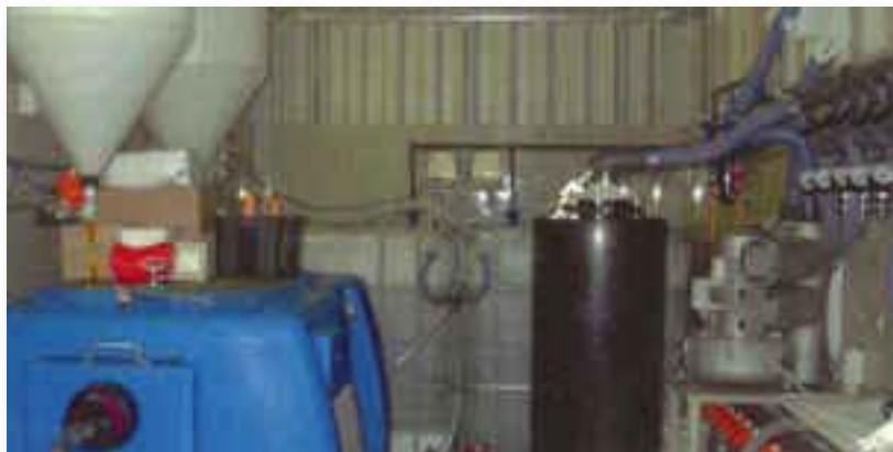
Épurateur belge total d'eau souterraine polluée. (Photo: Greensan).
