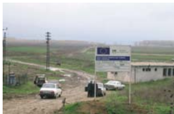
Un projet ISPA de traitement des eaux usées en Roumanie.
