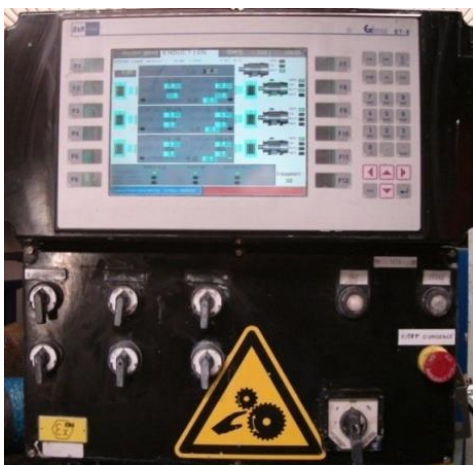
Fig. 17: L'ancien écran de supervision EXICOM.
